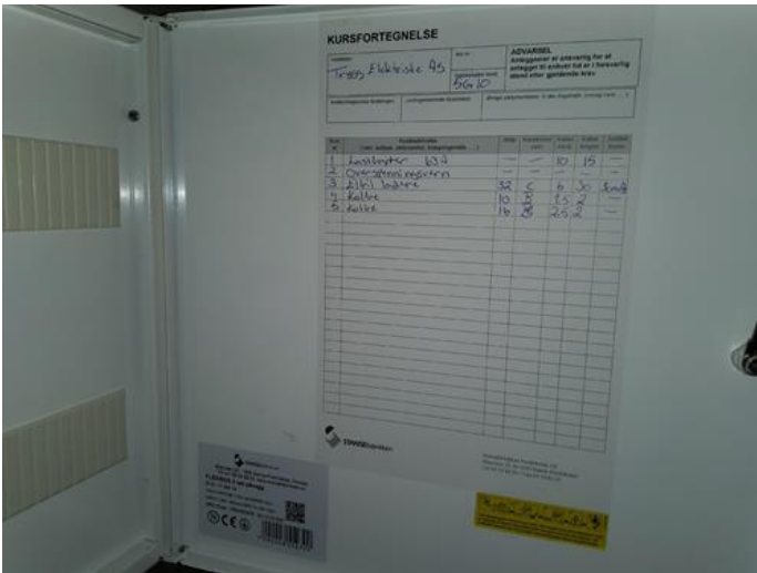
Elektrisk anlegg - [Kursfortegnelse teknisk rom.]
