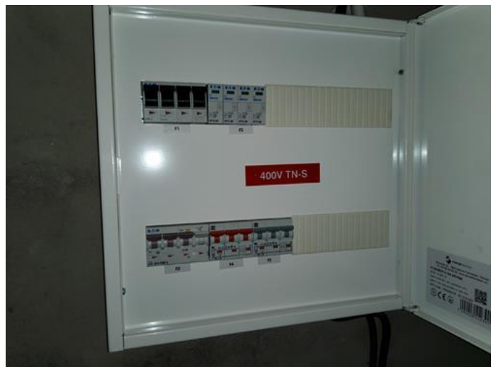
Elektrisk anlegg - [Sikringskap teknisk rom ]
