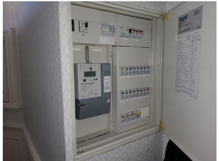
Elektrisk anlegg - [Sikringskap entré]
