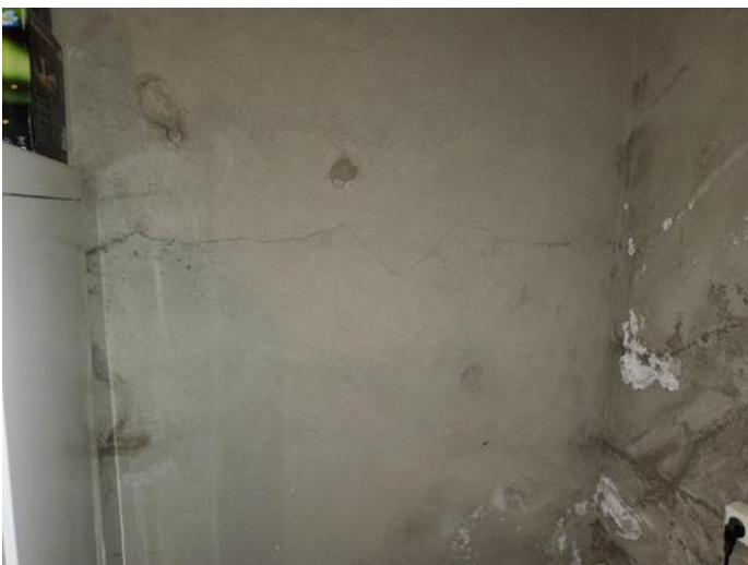
Kommentar - [Riss/sprekk i teknisk rom.]
