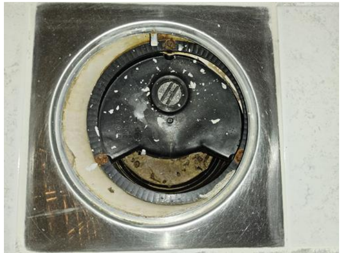
Avløpsrør (ink. sluk) - [Sluk bad]
