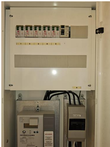
Elektrisk anlegg - [Sikringskap]
