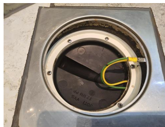
Vanntett sjikt / membran i golv og vegger - Sluk i dusjsone, bad underetasje.
