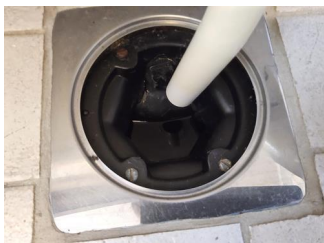
Vanntett sjikt / membran i gulv og vegger - Sluk i baderom i 2 etasje.
