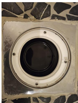
Vanntett sjikt / membran i gulv og vegger - Sluk i baderom i 1 etasje.
