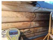
Overflate vegg - Fuktmåling stue.
