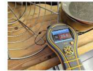
Overflate vegg - Fuktmåling kjøkken
