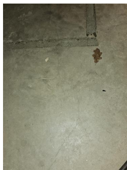
Innvendige forhold - Riss betonggulv garasje 2
