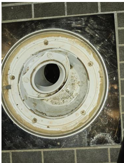
Tettesjiktets tilslutning til sluk - Sluk dusjnisse, bad 2
