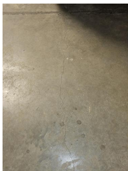
Innvendige forhold - Riss betonggulv garasje 1
